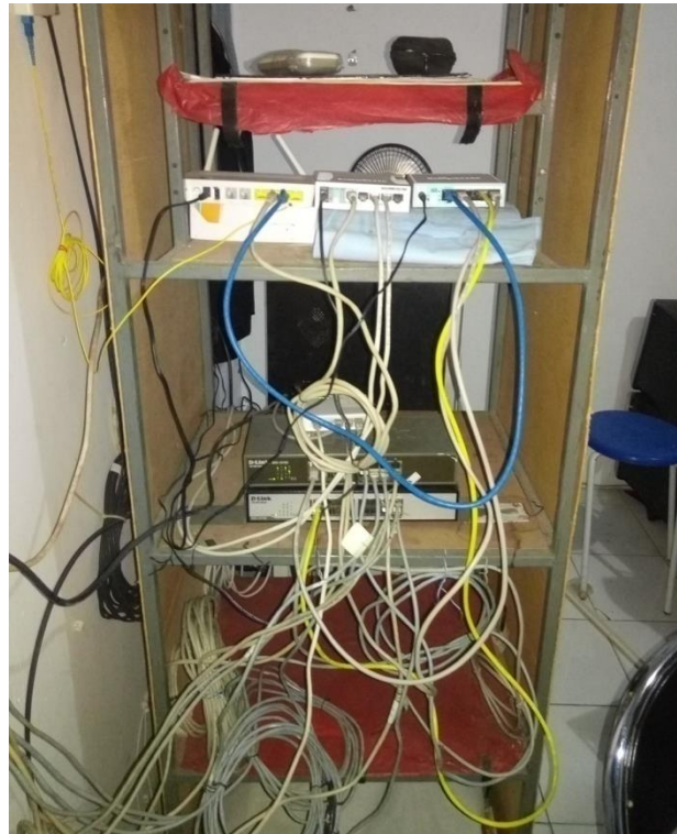
Gambar 4.1 Server di Ruang IT
